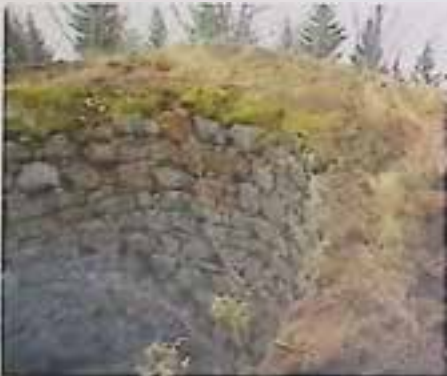
Abb 11: Burgruine Rutenstein, Grasnarbe auf Mauerkrone
