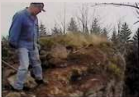
Abb 15: Burgruine Rutenstein, Mauerkrone vor Sanierung
