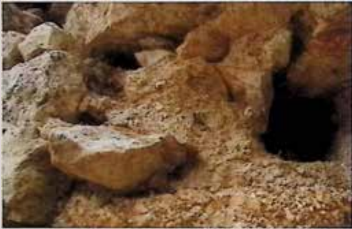
Abb 9: Burgruine Rutenstein, Mauerkerne
