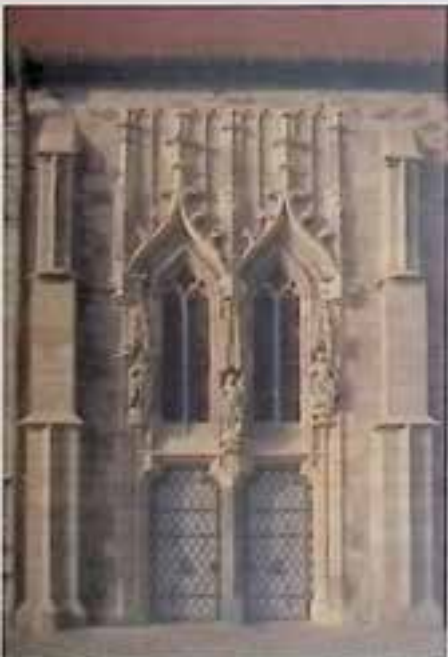
Eferding, Pfarrkirche, Südportal nach Behebung von Steinschäden
