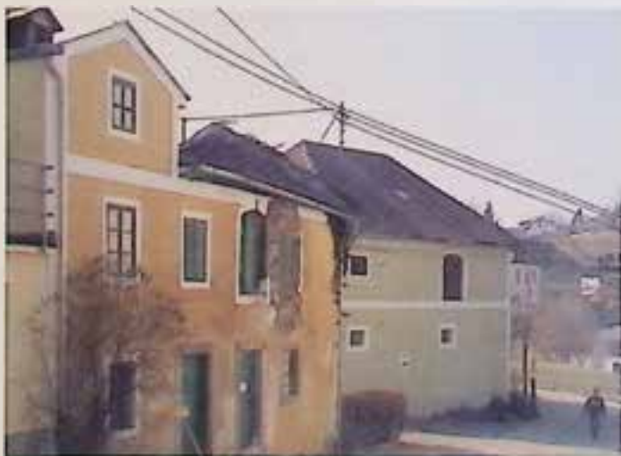
Gefährdet: Bei dem Brauereistöckl an der Hinterzeile des Neufeldener Marktplatzes wurden Sicherungsmaßnahmen unterlassen. – Foto: BDA.
