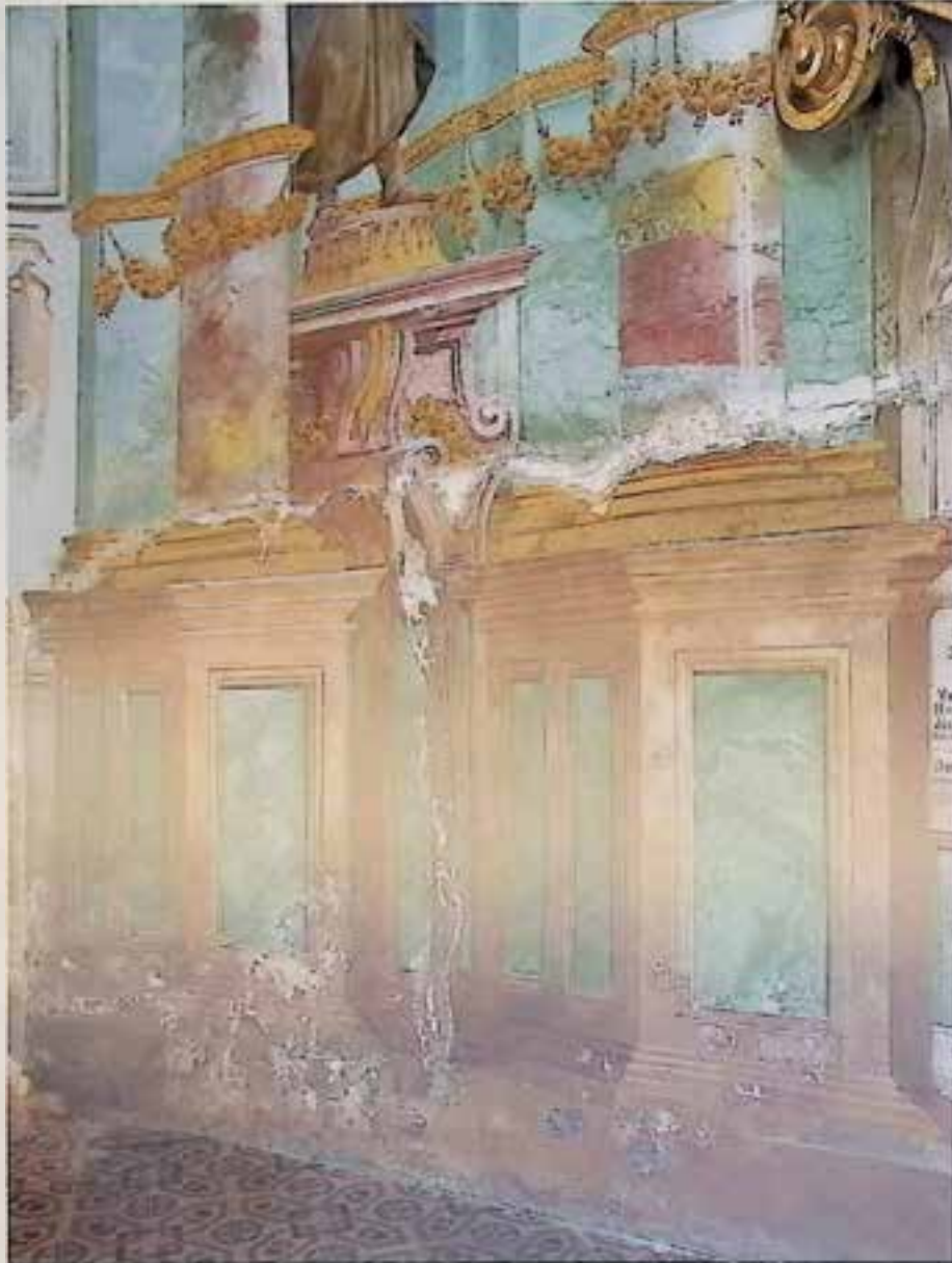
Hartkirchen, Pfarrkirche, scheinarchitektonischer Sockel des gemalten Hochaltars, aktuelle Schäden vor der Konservierung. – Foto: Preis&Preis.
