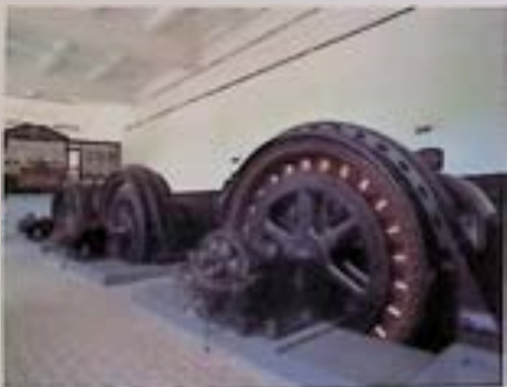
Kraftwerk Steyrdurchbruch, Maschinenhalle. – Foto: BDA.
