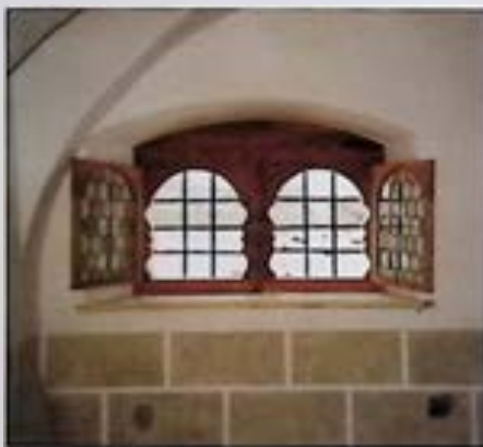
Kremsmünster, Regau 9, Vorhalle nach Restaurierung der Sockelquaderung und des „Bettlerfensters“. – Foto: BDA
