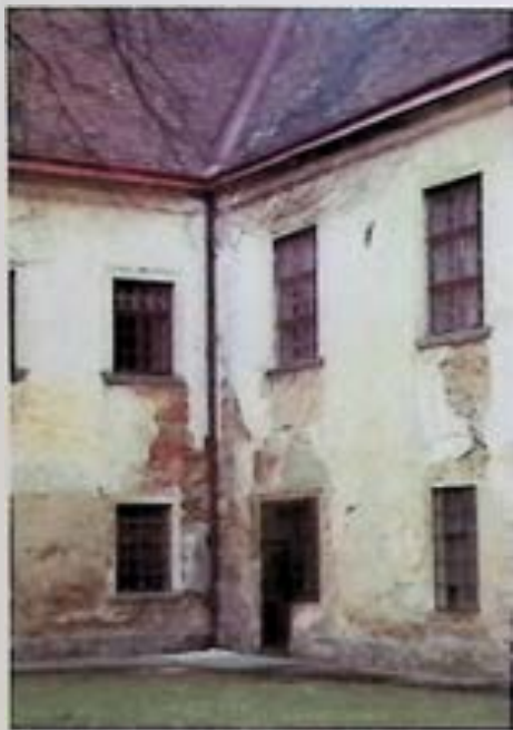
Die unkontrollierte Dachwasserableitung kann sich in ihr Gegenteil verkehren: Schäden durch defektes Fallrohr, neben Schäden durch mangelnde Wartung der Fenstersohlbänke.
