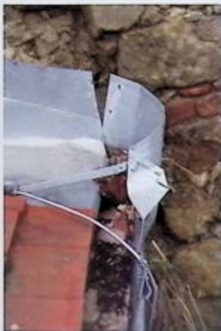
Verlegte Dachrinne als Ausgangspunkt von Schäden.
