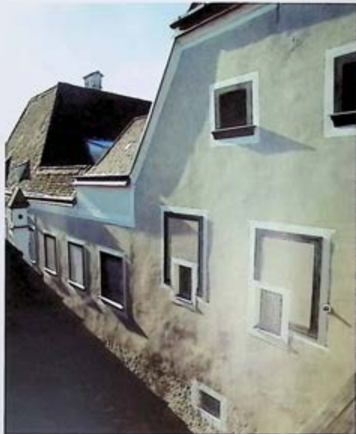
Steyr, Stadtplatz 34, Seitenfassade zur Mayrstiege nach Freilegung und Restaurierung der historischen Originalputze. – Foto: W. Ebenhofer.
