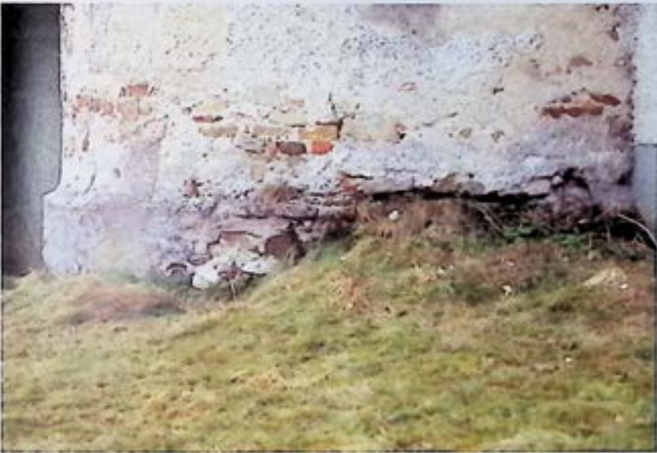
Schadenszone an einer Kirchenapsis durch unkontrollierte Geländeanschlüsse und mangelnde Dachwasserableitung. – Fotos: alle BDA.
