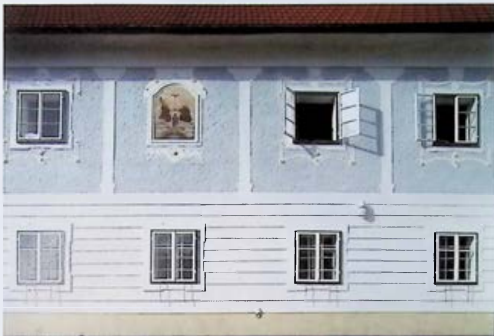
Gesicherter und gepflegter Zustand nach Reparatur und Anstrich der Fenster sowie Kalkfärbelung der Putzfassade.
