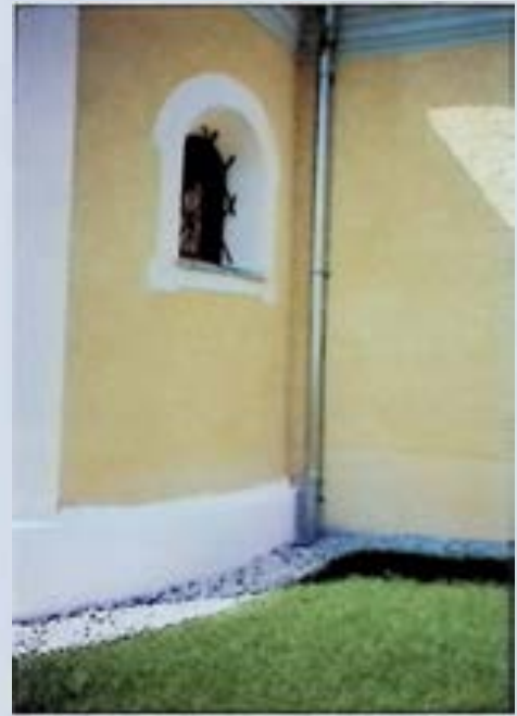
Derselbe Bereich nach Herstellung des gesicherten Zustands mit Niveauekorrektur, Drainage und Dachwasserableitung: Maßstab periodischer Kontrolle.
