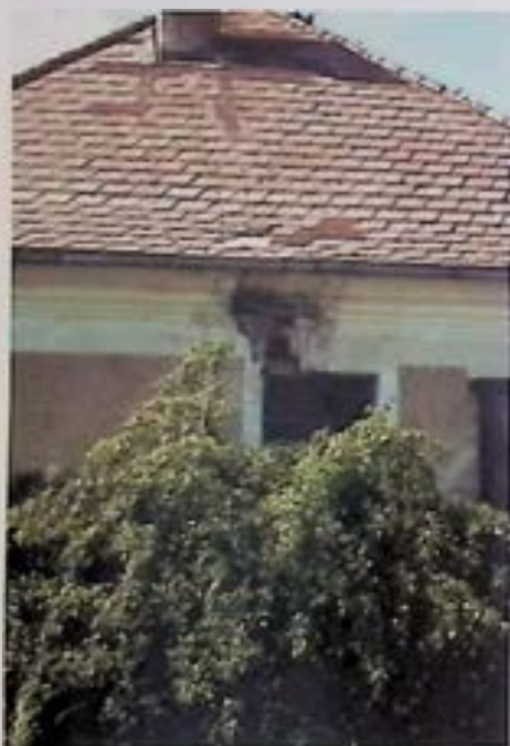
Kleine Ursache, große Wirkung: Bauschaden durch ein Loch in der Dachdeckung.
