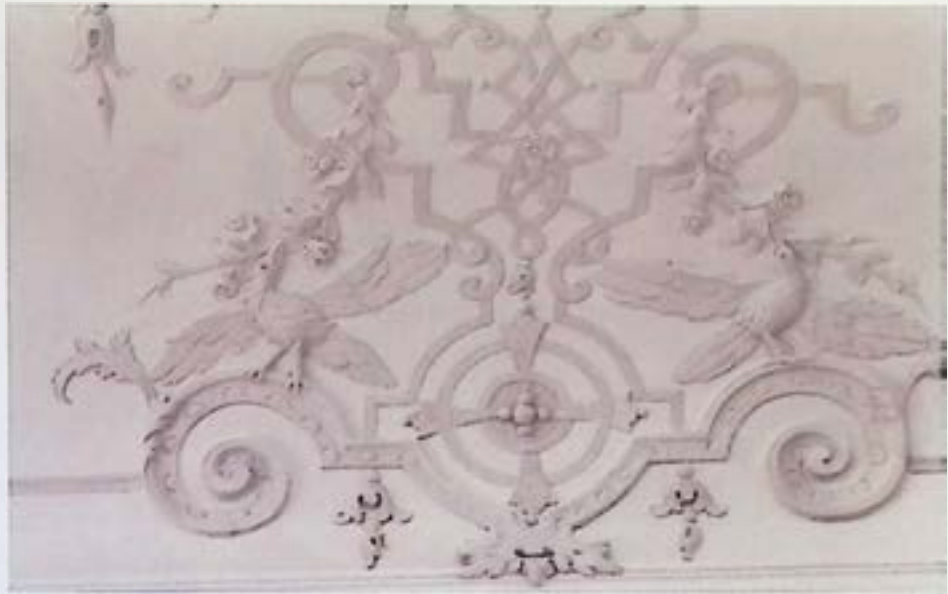
Wels, Herrenstraße 8, ehem. Palais Tilly, Stuckdecke nach Freilegung und Restaurierung, Ausschnitt. - Foto: J. Reiter
