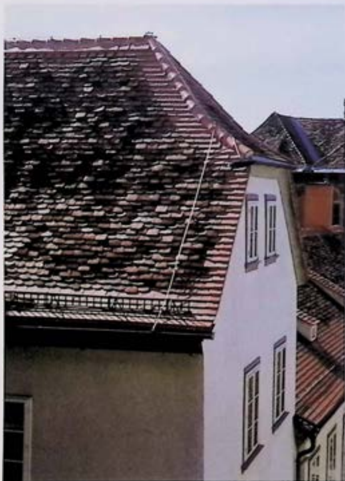
Die Reparatur eines alten Ziegeldachs durch sorgfältige Handwerkstechnik sichert das überlieferte lebendige Erscheinungsbild eines Bau- denkmals und spart Ressourcen. – Foto: BDA.
